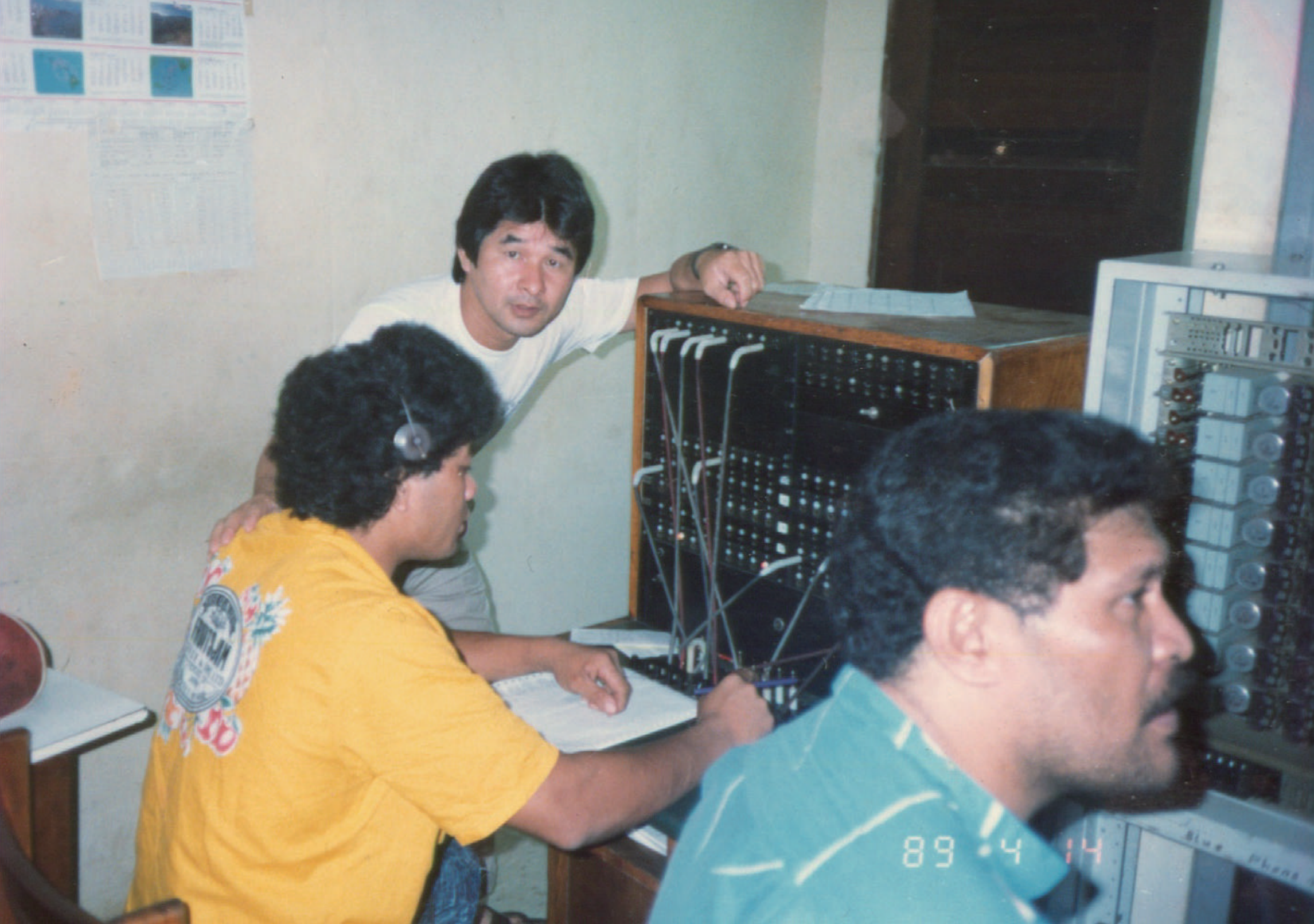
サモア人スタッフと一緒に点検で回った、サバイイ島の小さな村の電話交換所。当時はまだ手動の交換機でした。(1989年) / 山崎義行(S62-1宅内電話工事)
