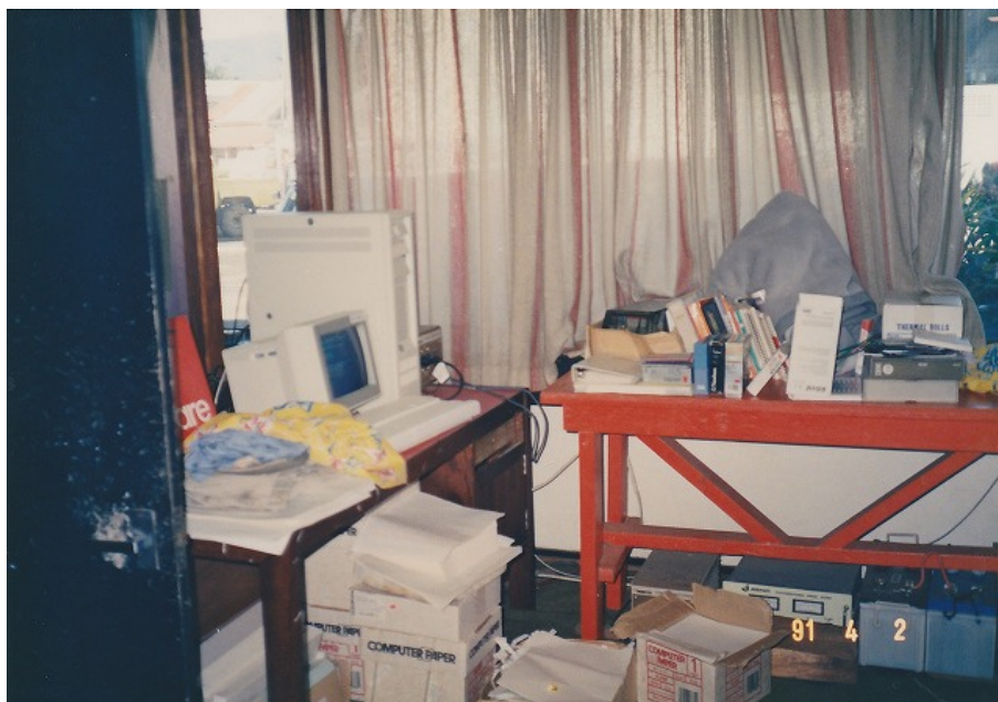
左側：サーバー 右下：停電用のバッテリー
